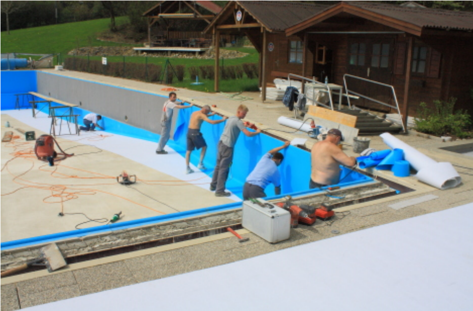
Einbau einer Einbaufolie in ein Poolbecken. Die Arbeiter sind dabei, die Folie in das Becken zu legen. Im Hintergrund ist ein Holzhaus zu sehen.
